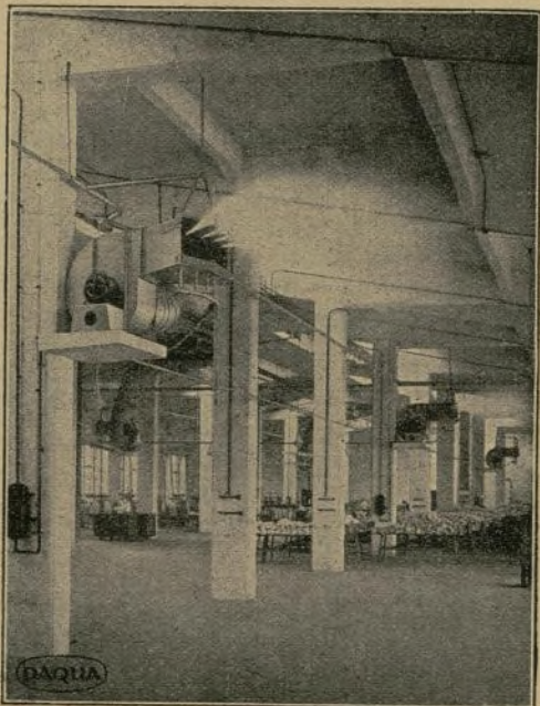
Instalación de humectación de aire del sistema DAQUA en una fábrica de artiseda.
