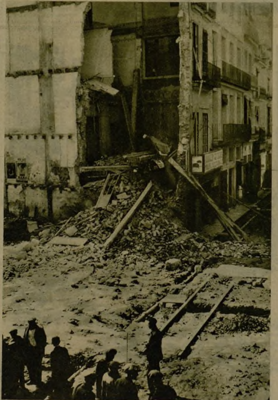
Estado en que quedó una casa en construcción de la calle de San Vicente, de Valencia, donde se produjo un hundimiento que alcanzó a la totalidad de la edificación. Por fortuna, no ocurrieron desgracias personales (Foto Lázaro)
