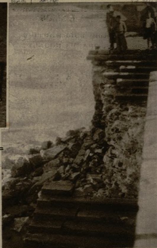
El temporal desencadenado en el Cantábrico ha causado daños en la costa asturiana. Así, en Gijón, durante la pleamar, el fuerte oleaje derribó la escalera de la playa de San Lorenzo
