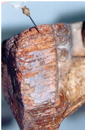
Detalle del proceso de consolidación de la madera debilitada por la acción biológica
