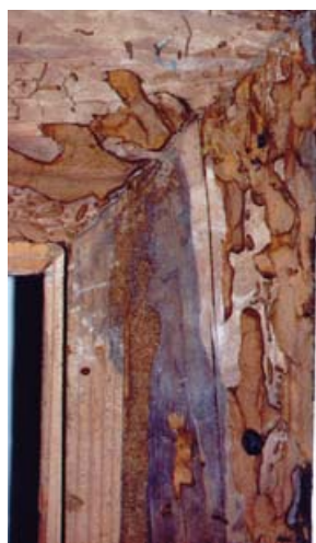
Detalle del deterioro producido por los insectos xilófagos en la parte trasera del marco
