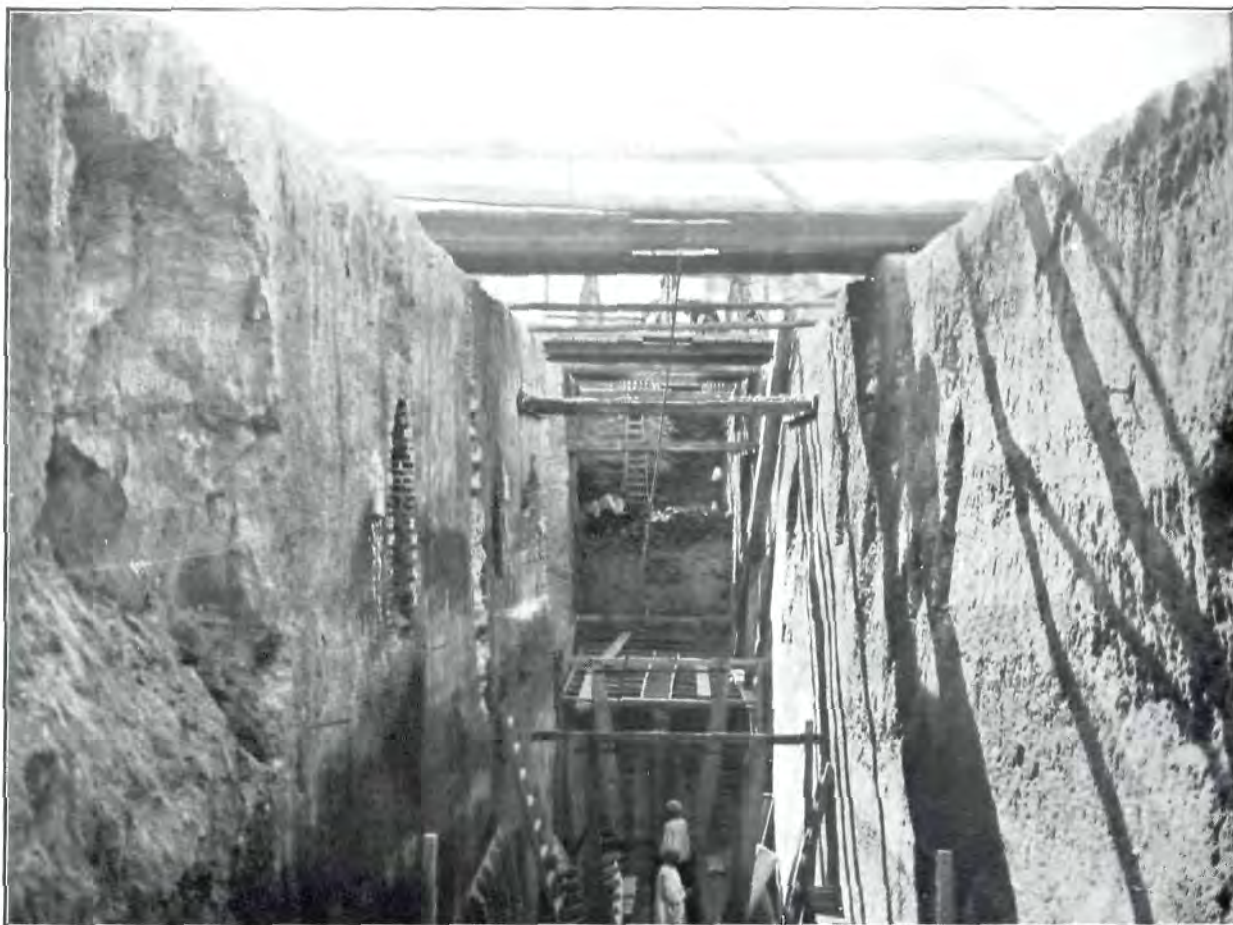
La grande tranchée de l'égout, vue prise du fond de la fouille.
