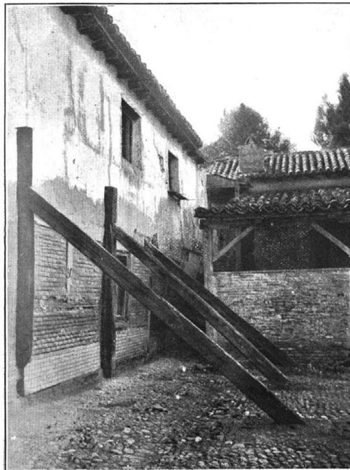
Parque de arrastres y talleres del Sur.—Resto del pabellón del Celador; que amenaza ruina.
