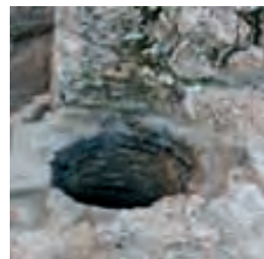
Pozo abierto en el muro occidental del patio
