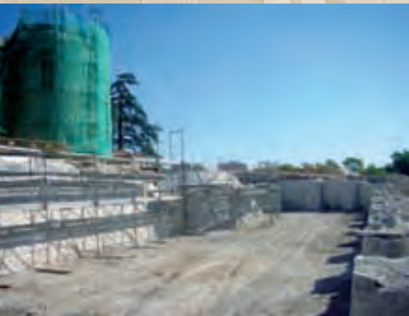
Arriba, a la derecha, plano del proyecto de reintegración del foso. Sobre estas líneas, vista de las obras en el lado sureste del foso
