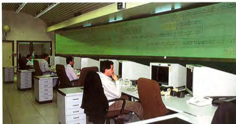
Puesto de Mando: Puesto Central de control de la circulación de trenes.
