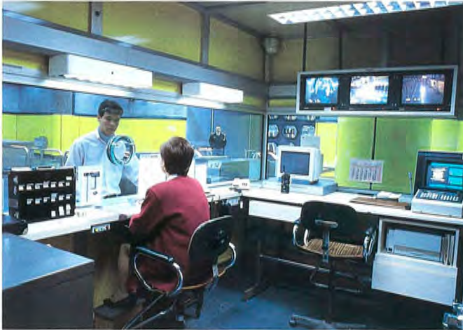
Puesto de Control Local (PCL). Estación Alto del Arenal.
