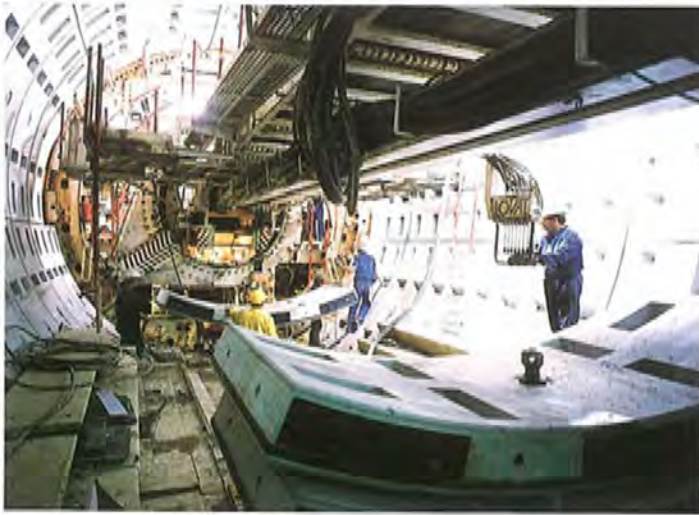
Proceso de montaje de dovelas en el escudo escavador. Tramo: Lago-Príncipe Pio
