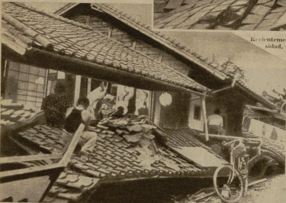
Los últimos terremotos en el Japón no solamente costaron la vida a incalculable número de personas, sino que dejaron la huella destructora de sus efectos en innumerables edificios (Foto Montaña)
