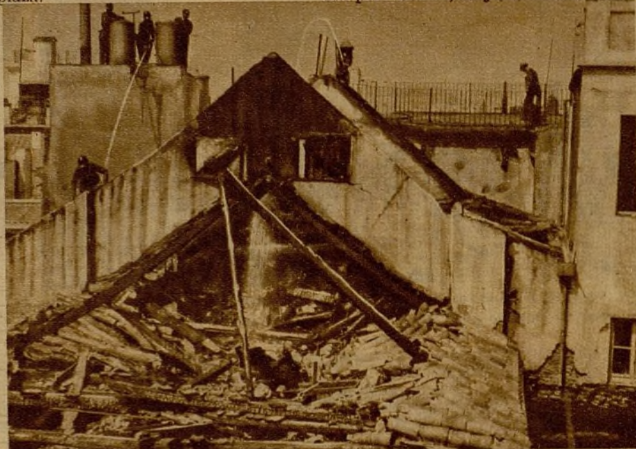
La techumbre de la capilla de San José, destruida por el fuego. Este edificio estaba comprendido en un viejo plan de ensanche, y para evitar su derribo, más que en atención a su mérito arquitectónico, fué declarado monumento nacional
