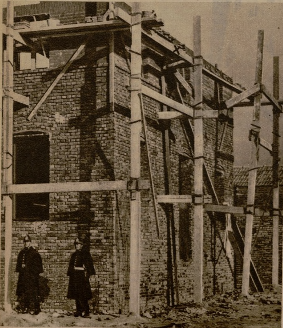
El andamio (x) de la casa de la calle de Oquendo que se hundió en la mañana de ayer, cuando se hallaban trabajando en él los obreros de la obra.
