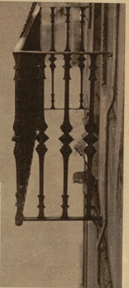
Estado en que quedó el balcón de la casa número 4 de la calle de Sugrañes, en cuyo hundimiento resultaron cinco heridos (Fotos Gonsanhi, Domingo y Pérez de Rozas)
