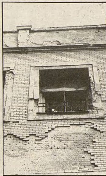
La rehabilitación de viviendas es otra de las tareas asumidas por la EMV
