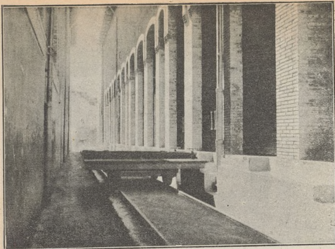
Celda de los transformadores y carreta transportadora al taller para reparaciones merced á lo cual en caso de inutilizarse un transformador puede ser sustituido ó reparado fácilmente.
