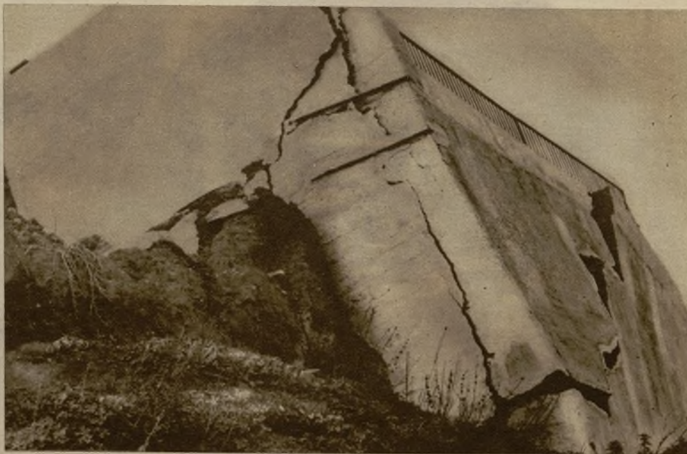
Esta casa se corrió más de diez metros por el plano inclinado, socavados sus cimientos por las aguas del Guadalquivir (Foto Gonsanhi)
