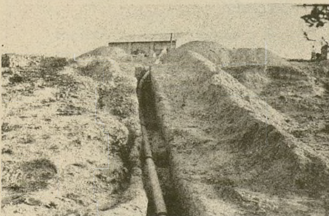
Vista de la conducción de agua del pozo núm. 3 al depósito propiedad del Ayuntamiento de Elche por presión forzada.
