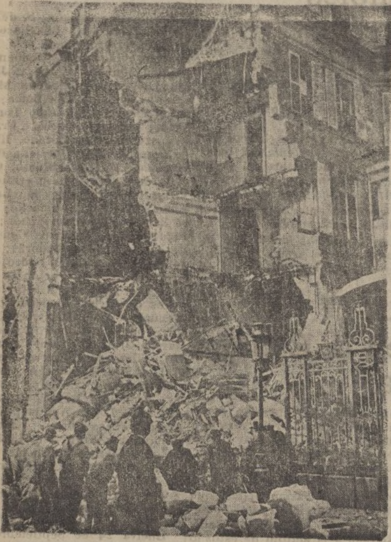
La fachada destruída del edificio de la Confederación General del Patronato, en la rue de Presbourg
