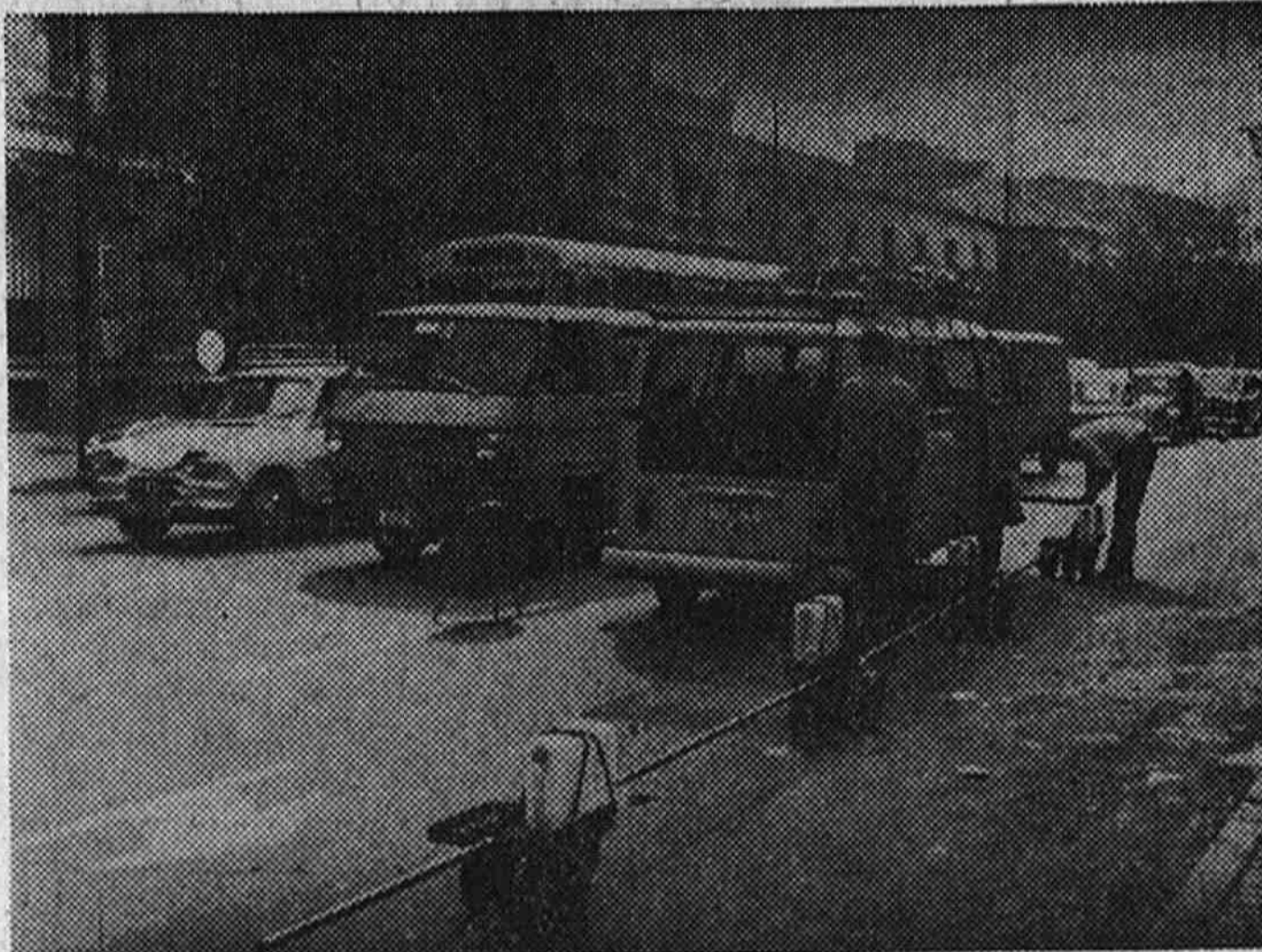
Las anomalías del subsuelo pueden detectarse desde la superficie. En las experiencias realizadas en Madrid con equipos electrónicos se han localizado fugas de agua y de gas. En la foto, un grupo de técnicos situando el punto exacto de una fuga de agua en la calle Joaquín García Morato
