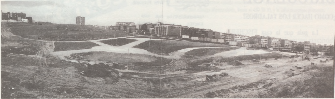
Obras son amores y nunca mejor dicho que en este caso del Parque de la Huerta del Obispo. Comenzaron las obras en el mes de Septiembre de 1990 y ya están a punto de repoblar.
