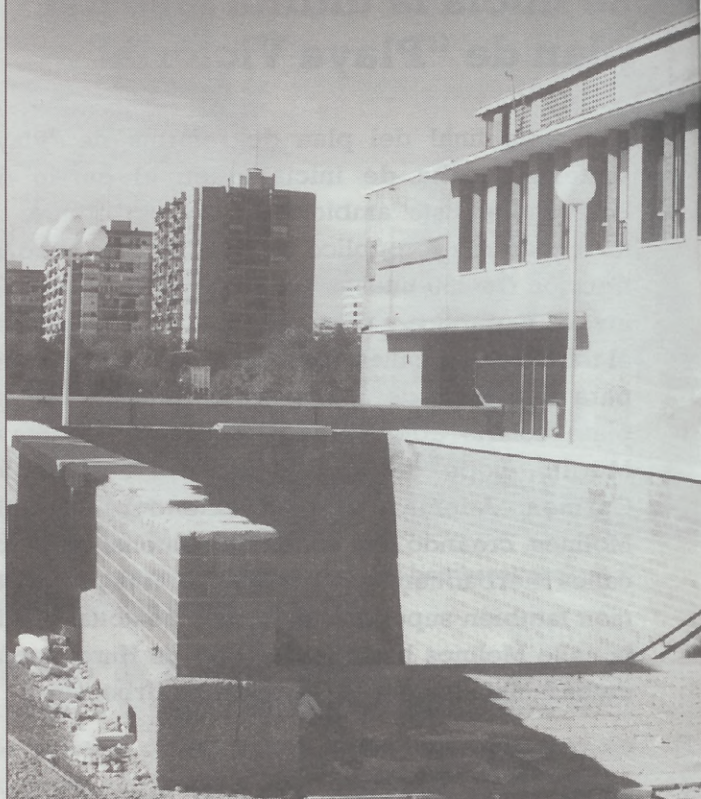
Accesos en el parque, Junto al Teatro de Madrid donde se puede apreciar el deterioro de las instalaciones
