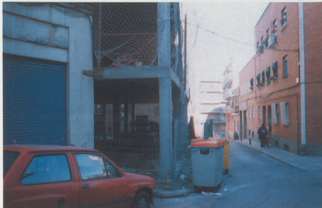
Un edificio en construcción de nueva planta sobresale notoriamente de cualquier alineación lógica, produciendo un estrechamiento inexplicable. ¿Cómo es esto posible?
